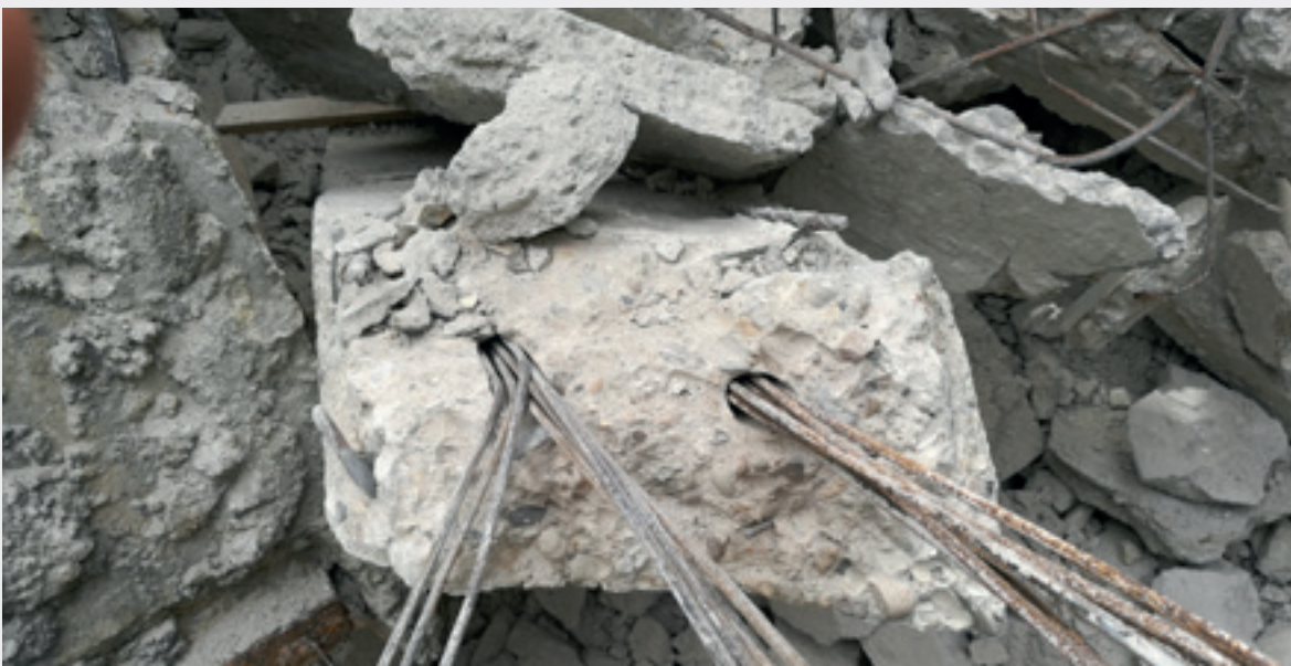
▼ Obr. 6 Kolaps vazníku
