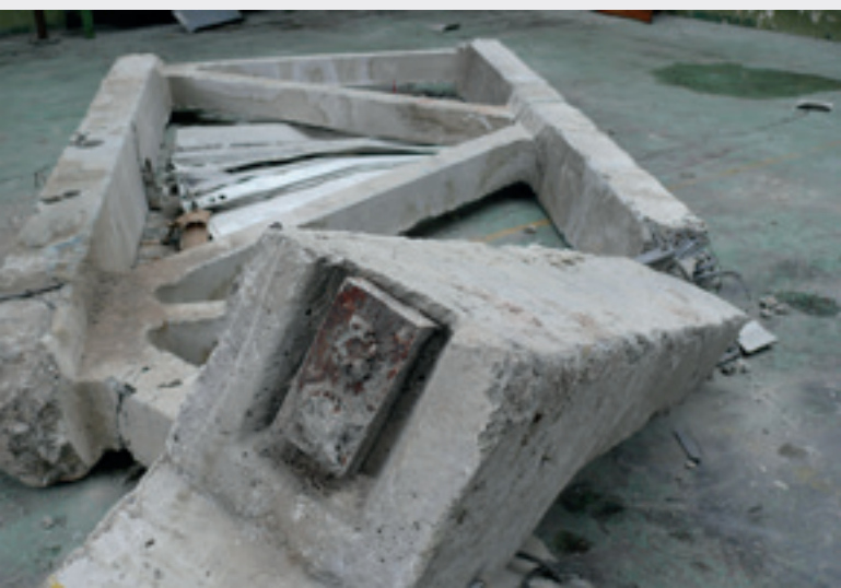
▼ Obr. 9 Foto kanálků se zkorodovanou, nezainjektovanou předpjatou výztuží
