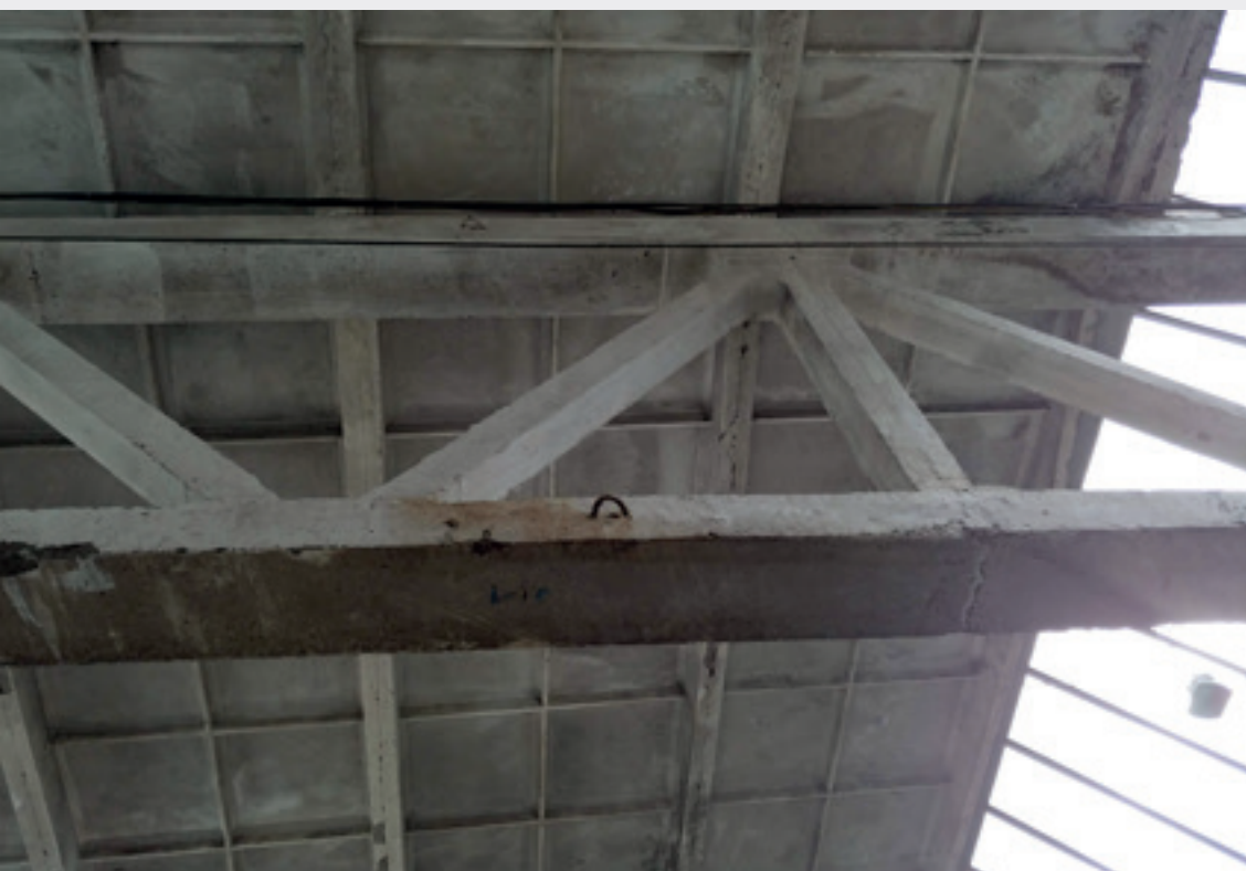
▲ Obr. 8 Foto kotevního místa předpjaté výztuže po kolapsu vazníku
