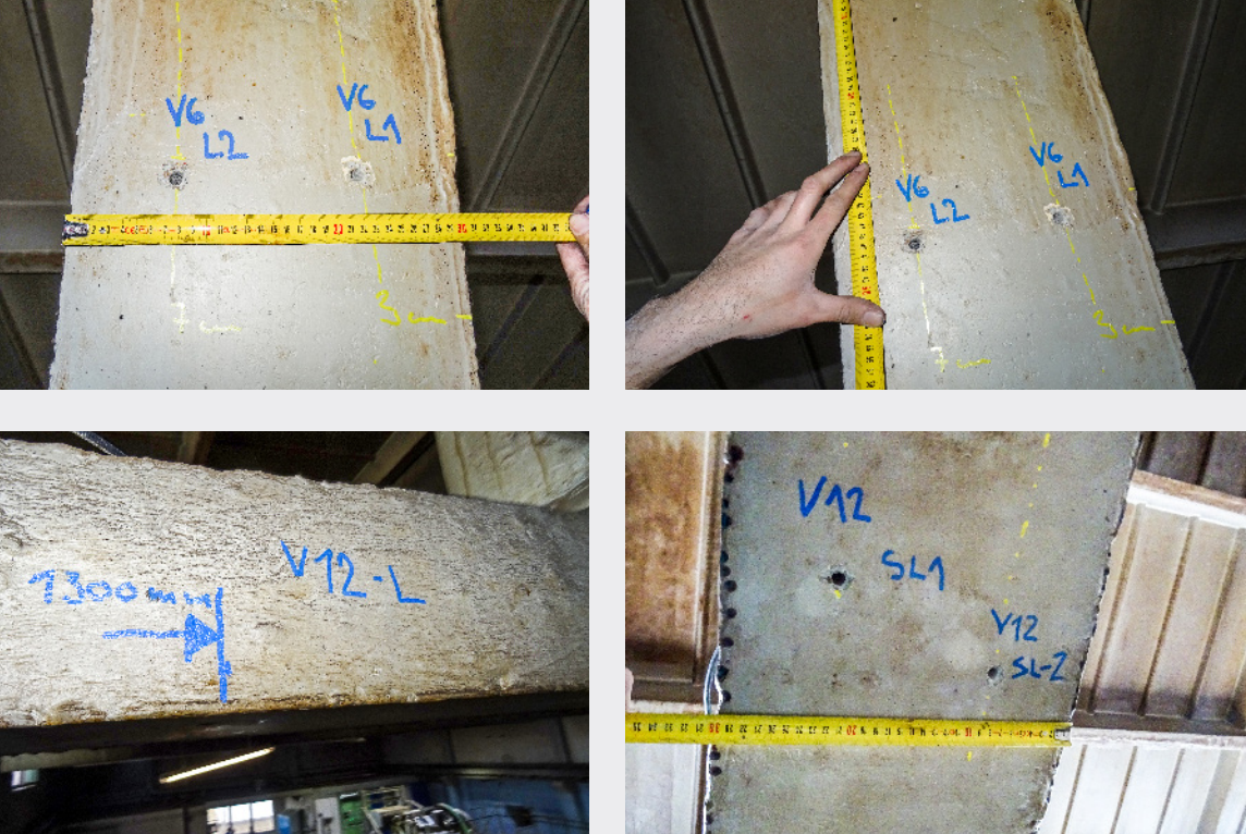
▲ Obr. 11 Ilustrační pohledy na kontrolní vývrty endoskopického průzkumu na levém krajním diagonálním prutu vazníku (11a, 11b) a v levé části dolního pásu vazníku ve vzdálenosti 1 300 mm od dolní kotevní oblasti (11c, 11d)
